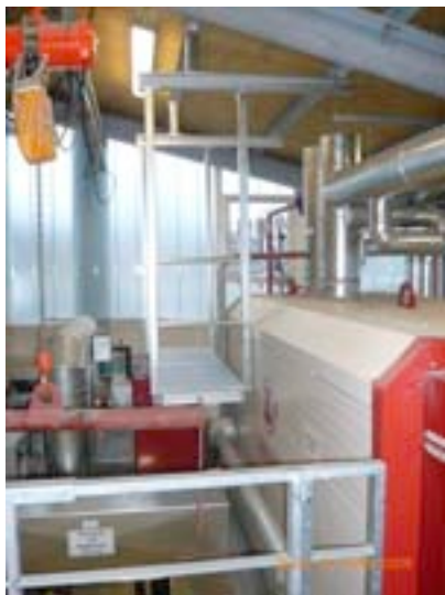
Holzhackschnittelanlage am Kreisberufsschulzentrum Ellwangen
