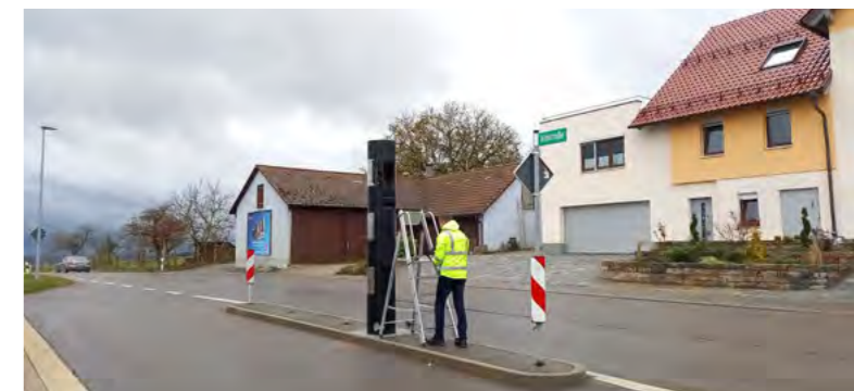
(Oben) Messstellenbesichtigung mit Projektierung einer Geschwindigkeitsmessanlage
