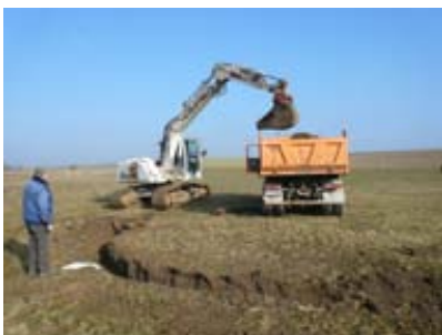
Beim Graben des neuen Bachlaufes. Durch den kleinen Bachquerschnitt wird bereits bei erhöhtem Wasserabfluss das Wiesental überschwemmt und dadurch die alten feuchten Bachwiesen wieder geschaffen. Bereits jetzt trifft man Silberreiher, Kiebitz, Bekassinen und Zwergschnepfen an, die an anderen Orten des Ostalbkreises kaum noch vorkommen
