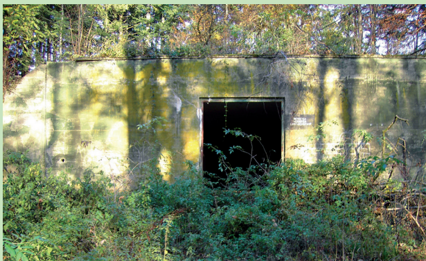
Zerfallener Bunker, Aufnahme von 2013.
